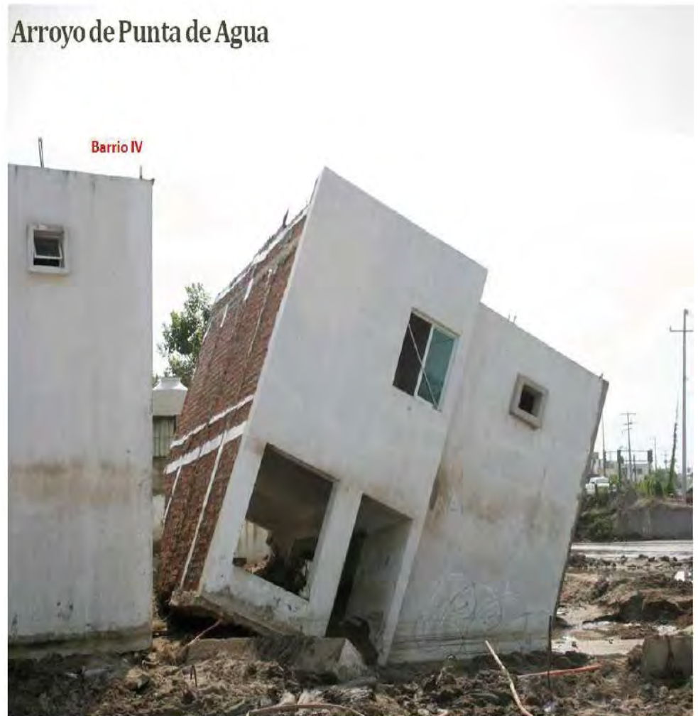
Foto. Secretaría de Desarrollo Agrario, Territorial y Urbano y Universidad Mexiquense del Bicentenario, 2017. Colapso de vivienda (Barrio IV) por socavación provocada por desborde fluvial. [fotografía]. Perfil de Resiliencia Urbana, Manzanillo, Colima
